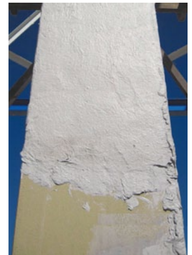
Рис. 2. Пример разрушений огнезащитного покрытия в коррозионноактивной среде
