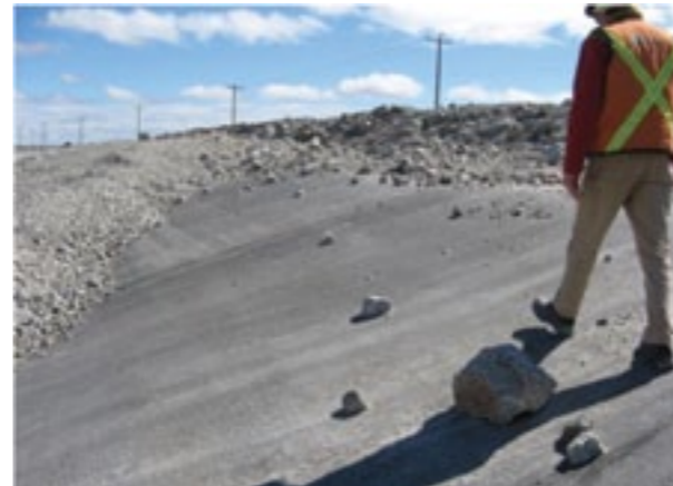
Рис. 5. Открытие BGM мембраны (водохранилище № 14). Температуры: от -70\text{ }^{\circ}\text{C} до +25\text{ }^{\circ}\text{C} . Результат после 5 лет эксплуатации: отсутствие каких-либо изменений BGM мембраны
