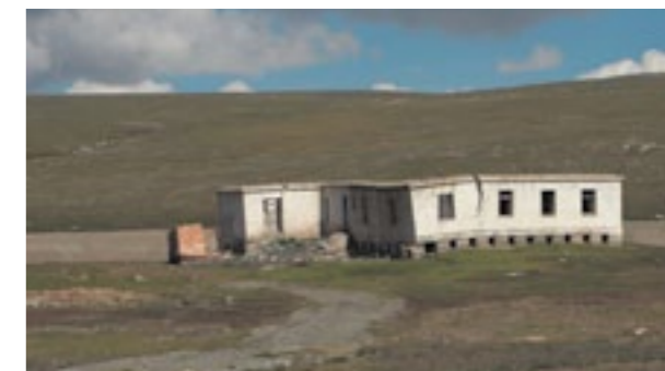
Рис. 6. Кумторский сырт. Метеостанция «Тянь-Шань». 3654 абс. м. Не функционирует с 1948 г. Здание станции деформировано процессами, вызванными деградацией «вечной мерзлоты»
