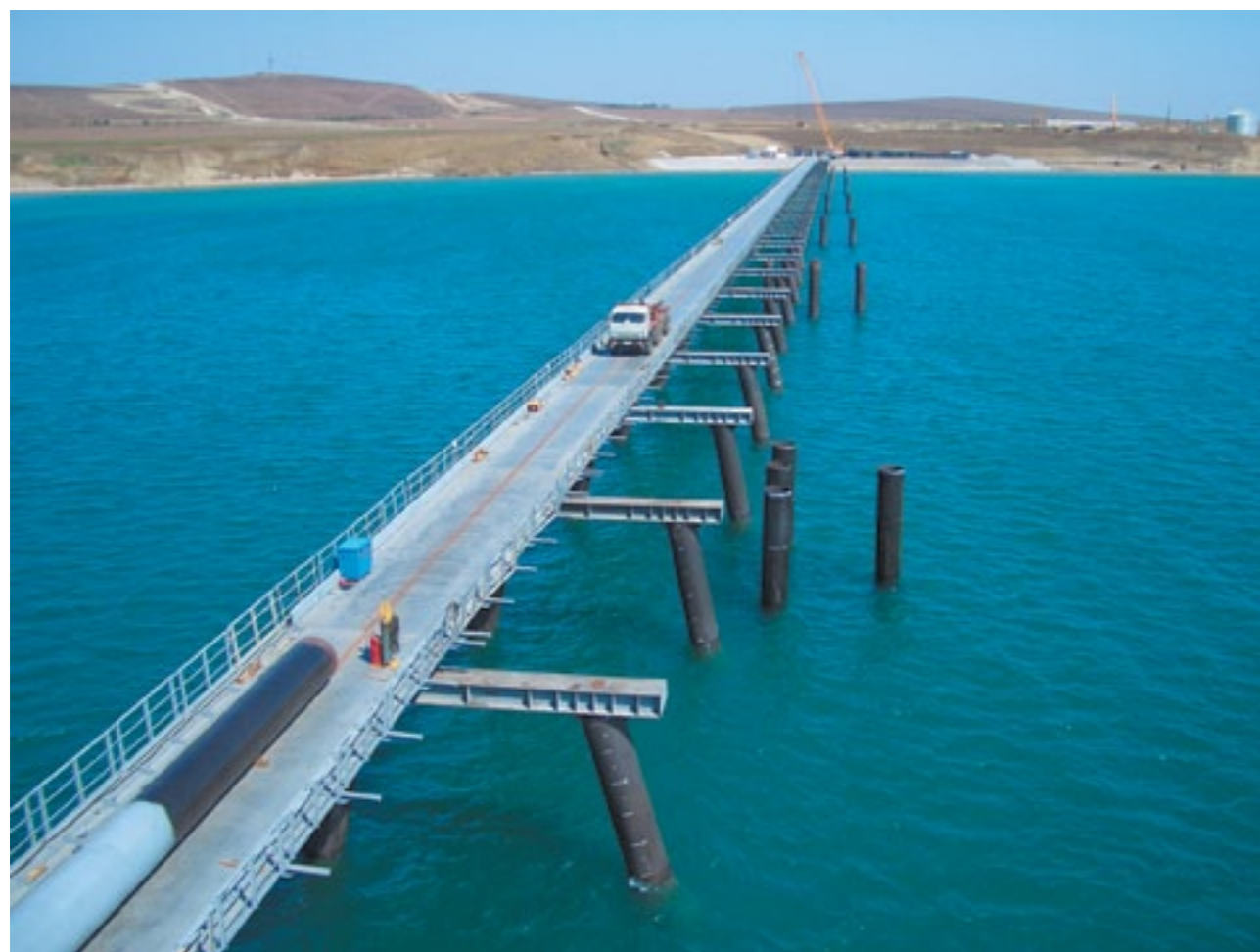
Рис. 1. Сваи и пролетные строения причала комплекса перевалки СУГ в порту Железный Рог
